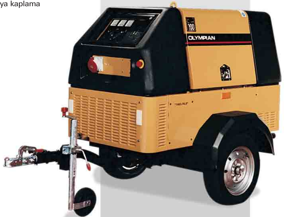
18 kVA dizel jeneratör seti ve römork
